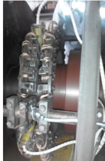
Рис. 7 – Установка первинних перетворювачів на щітково-контактному апараті
